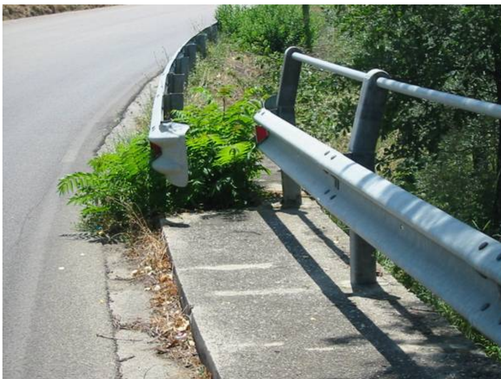
Figura 60 Barriera per bordo laterale e per bordo ponte non collegate: problema di grado elevato.
