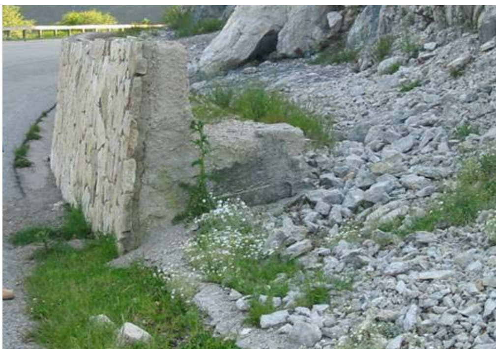
Figura 65 Muro in pietra: problema di grado elevato.
