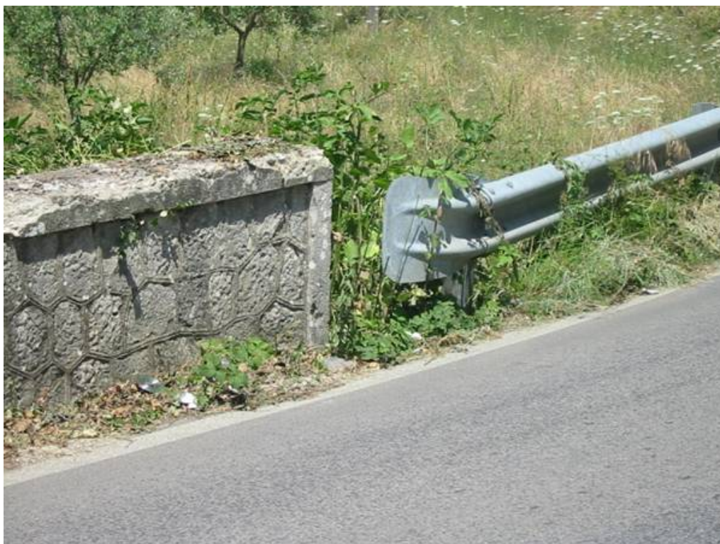
Figura 59 Barriera metallica e muro in pietra non collegati: problema di grado elevato.
