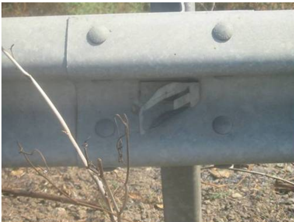
Figura 12 Assenza di catarifrangenti nelle barriere di sicurezza: problema di grado elevato.
