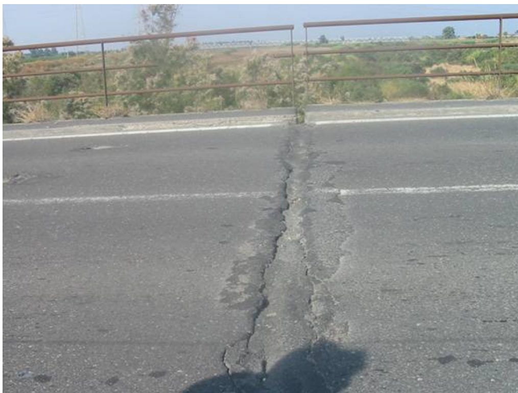
Figura 43 Giunto di viadotto dissestato: problema di grado alto.
