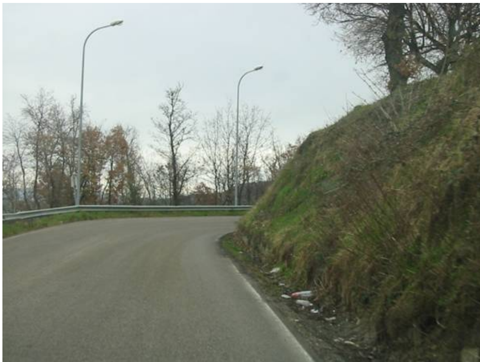
Figura 27 Mancanza di visibilità in curva: problema di grado elevato.
