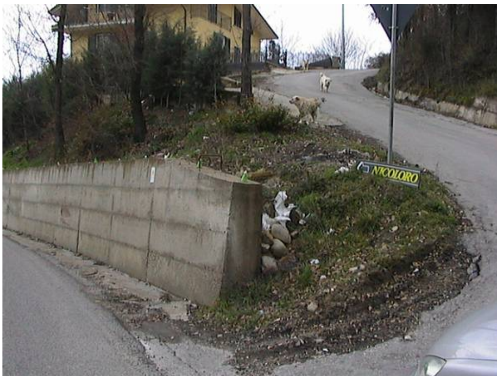
Figura 66 Muro in calcestruzzo: problema di grado elevato.
