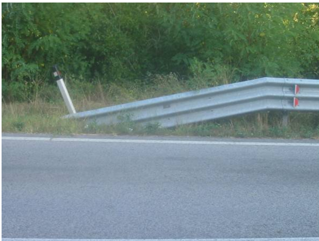
Figura 57 Terminale inclinato a terra: problema di grado elevato.
