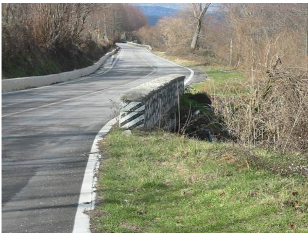
Figura 67 Paracarro: problema di grado elevato.
