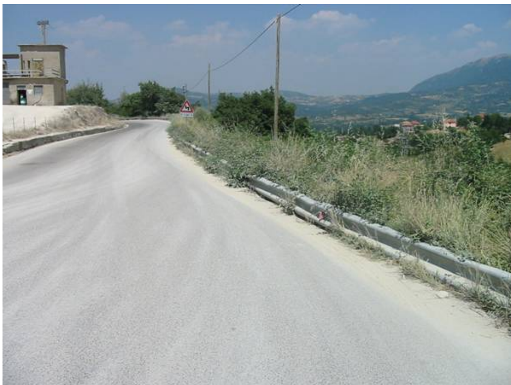
Figura 49 Rilevato alto protetto con barriera inefficace: problema di grado elevato.
