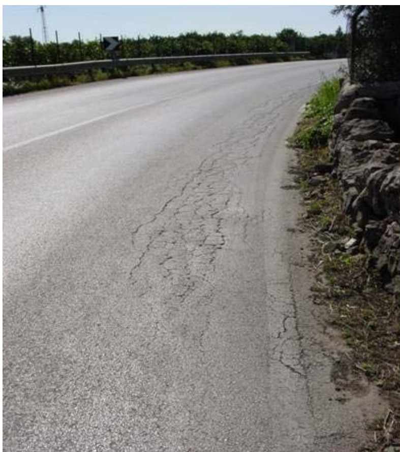
Figura A22 - Fessurazioni ed avvallamenti all'interno della curva– direzione -----
