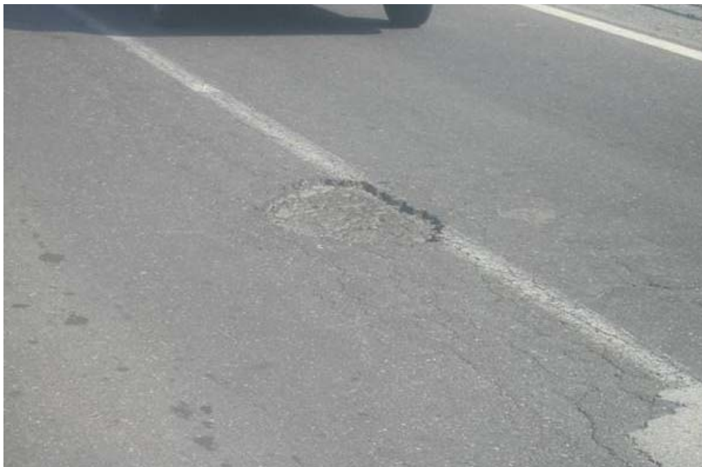
Figura 46 Buca superficiale in rettilineo: problema di grado lieve.
