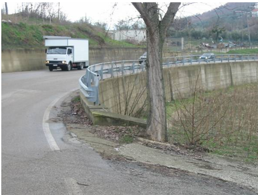
Figura 56 Terminale pericoloso di barriera per opera d'arte: problema di grado elevato.
