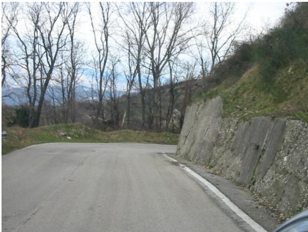
Figura 4 Curva con difficoltà di percezione non delineata: problema di grado elevato.
