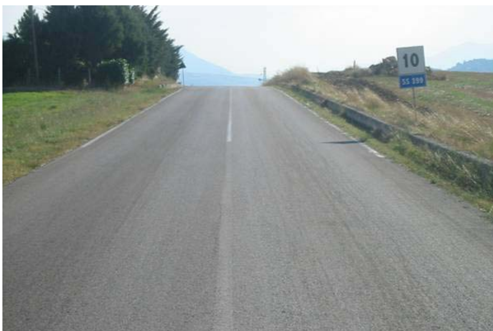
Figura 32 Mancanza di visibilità in un dosso: problema di grado elevato.
