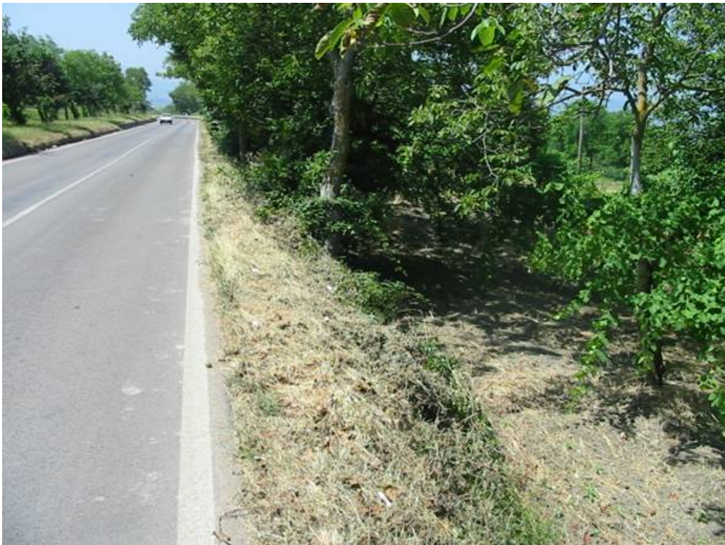
Figura 48 Rilevato di media altezza non protetto: problema di grado elevato.
