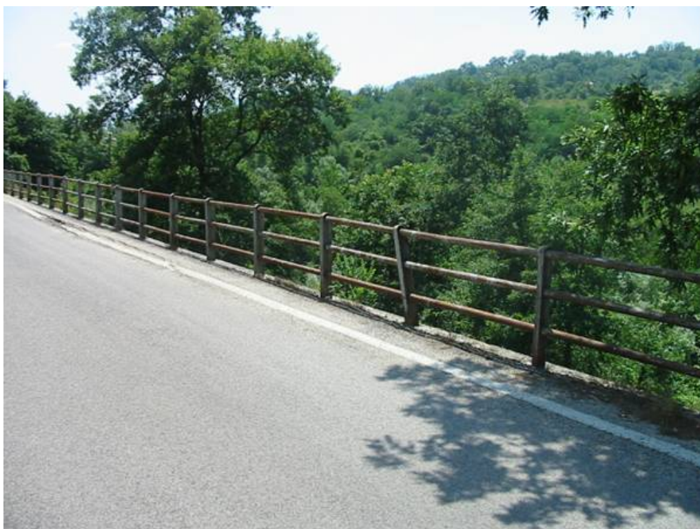
Figura 53 Barriera per bordo ponte inefficace: problema di grado elevato.
