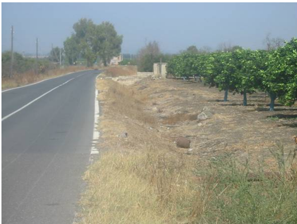
Figura 51 Rilevato basso non protetto: problema di grado lieve.
