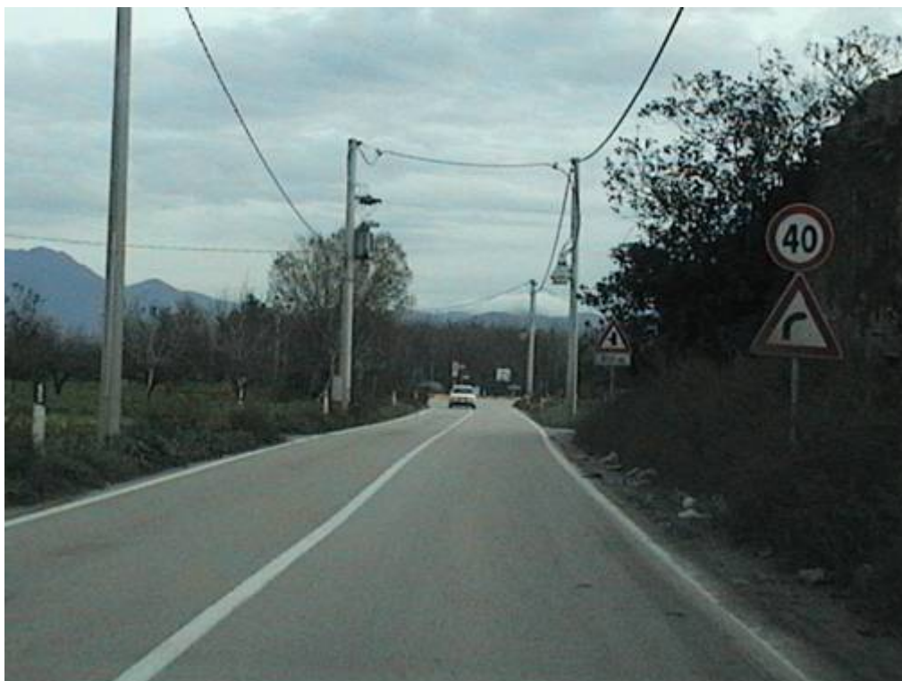
Figura 64 Pali in calcestruzzo vicini alla carreggiata: problema di grado elevato.
