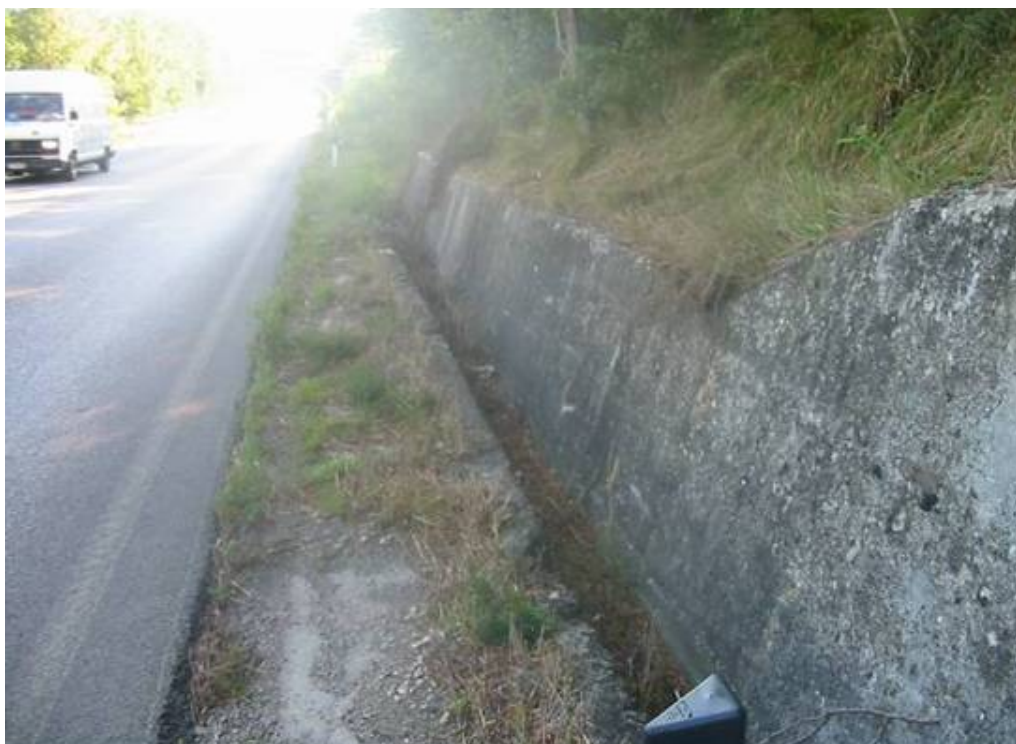
Figura 70 Cunetta rettangolare non protetta: problema di grado elevato.
