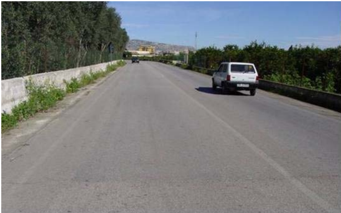
Figura A5 - Assenza di delineatori di normali di margine.
