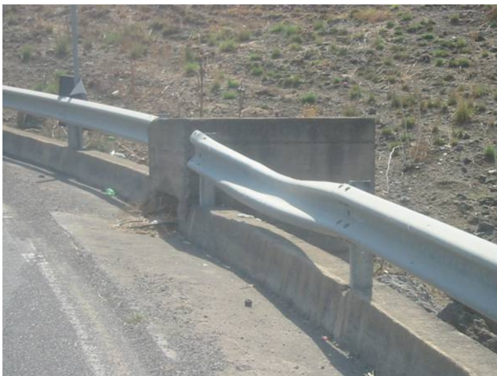
Figura 58 Barriera metallica e muro in calcestruzzo non collegati: problema di grado elevato.
