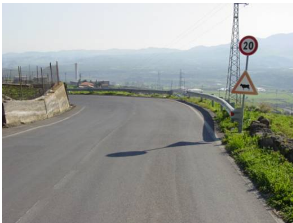
Figura 50 Rilevato alto protetto con barriera inefficace a causa della limitata lunghezza di installazione: problema di grado elevato.
