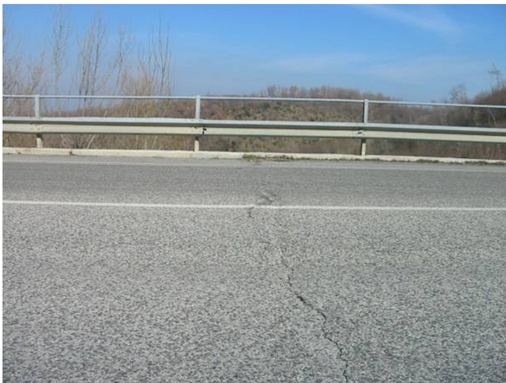
Figura 54 Barriera per bordo ponte con bassa capacità di contenimento: problema di grado elevato.
