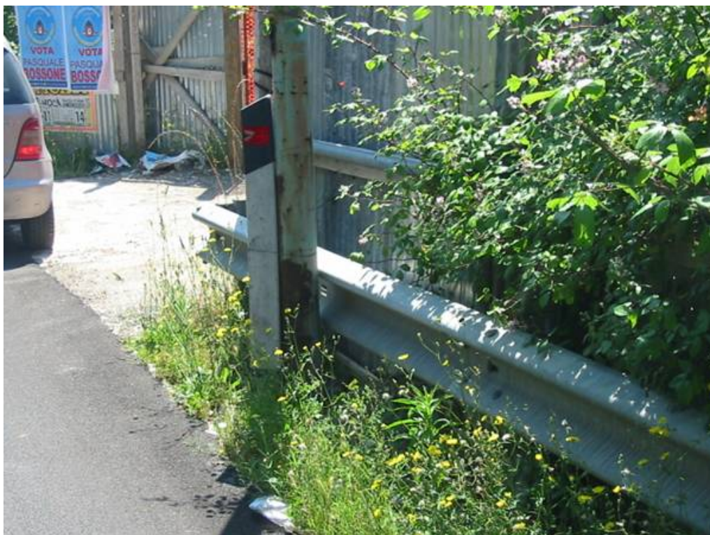
Figura 69 Palo della luce metallico di piccolo diametro: problema di grado lieve.
