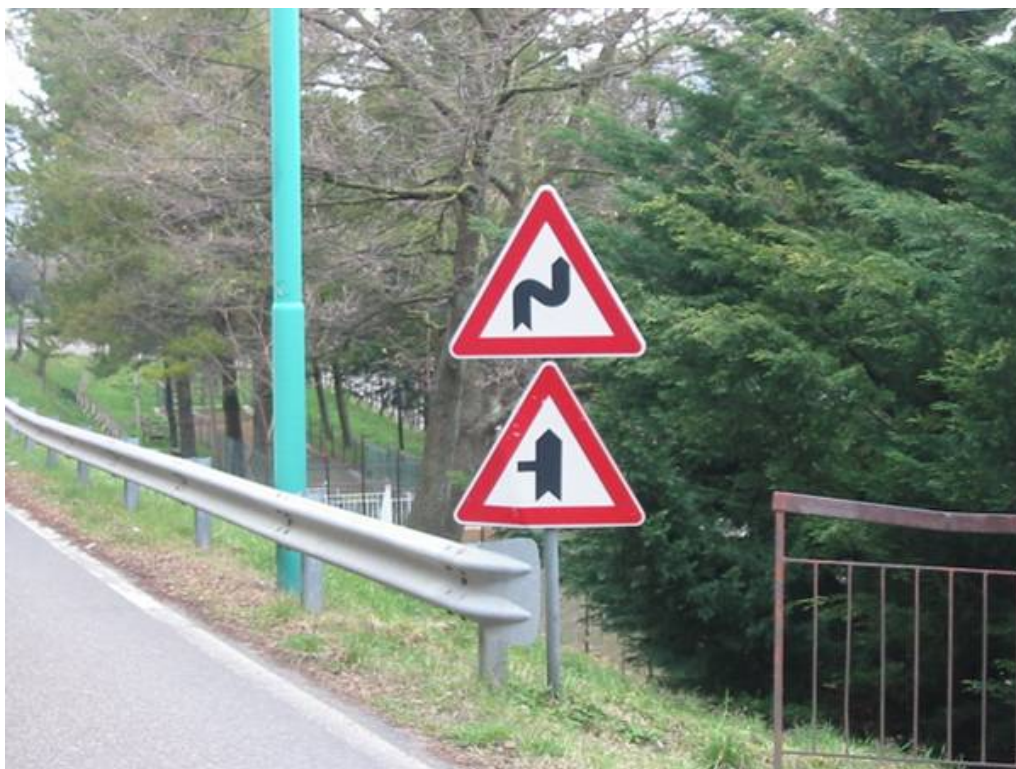
Figura 17 Segnali installati ad altezza non corretta.
