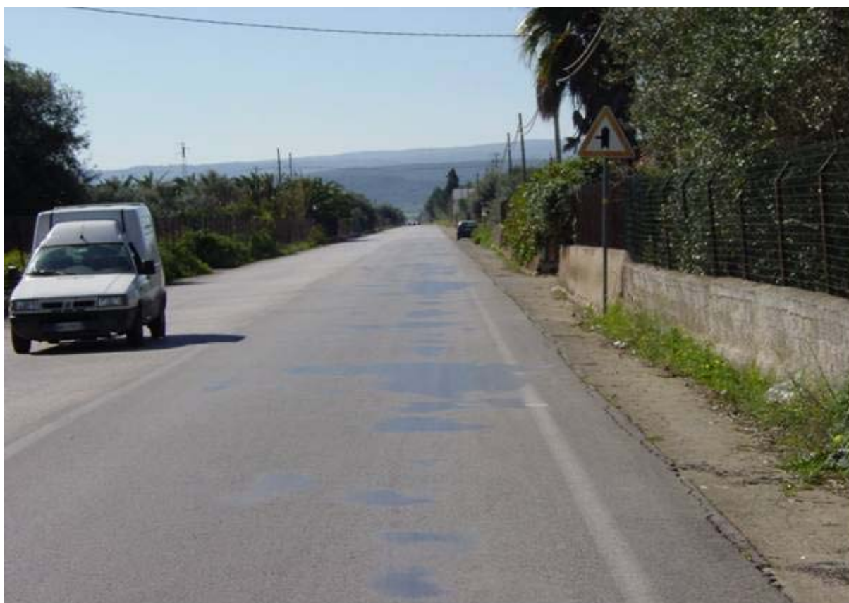
Figura A14 - Risalita di bitume.
