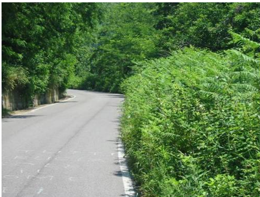
Figura 26 Banchine assenti: problema di grado elevato.
