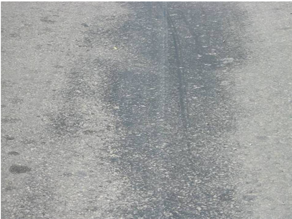
Figura 40 Risalita di bitume.
