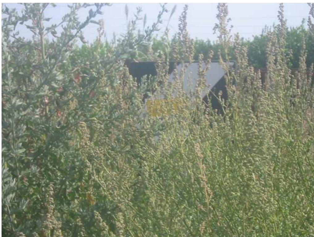
Figura 8 Delineatore completamente coperto dalla vegetazione: problema di grado elevato.
