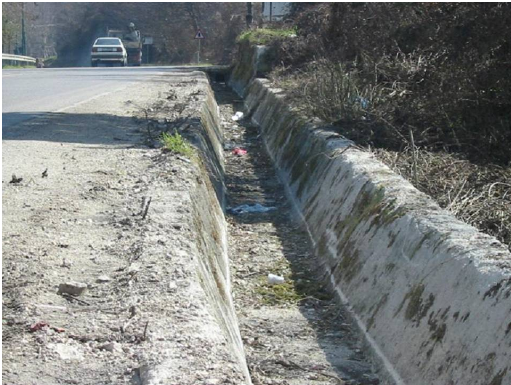
Figura 72 Cunetta trapezia non protetta: problema di grado elevato.
