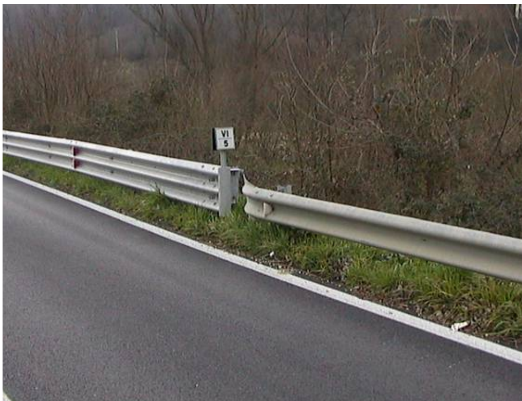
Figura 61 Barriere per bordo laterale non collegate: problema di grado elevato.
