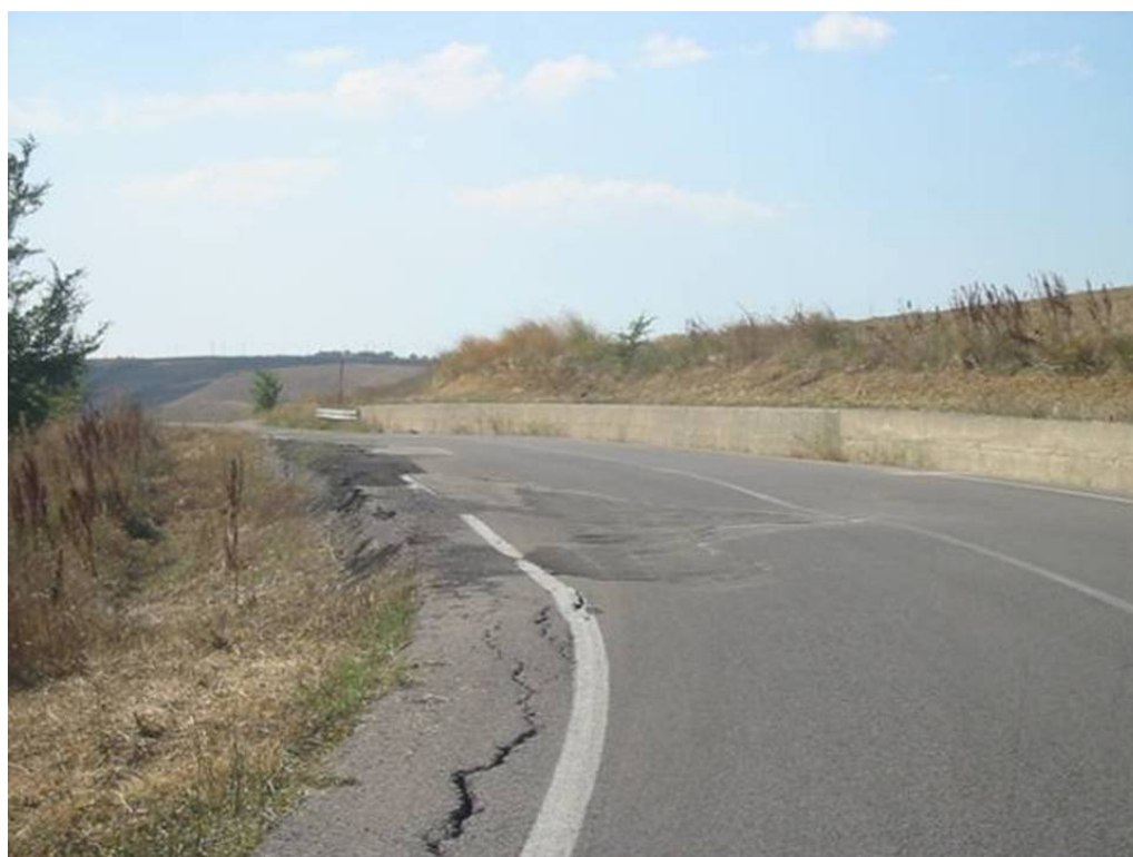
Figura 45 Irregolarità della pavimentazione in curva: problema di grado elevato.
