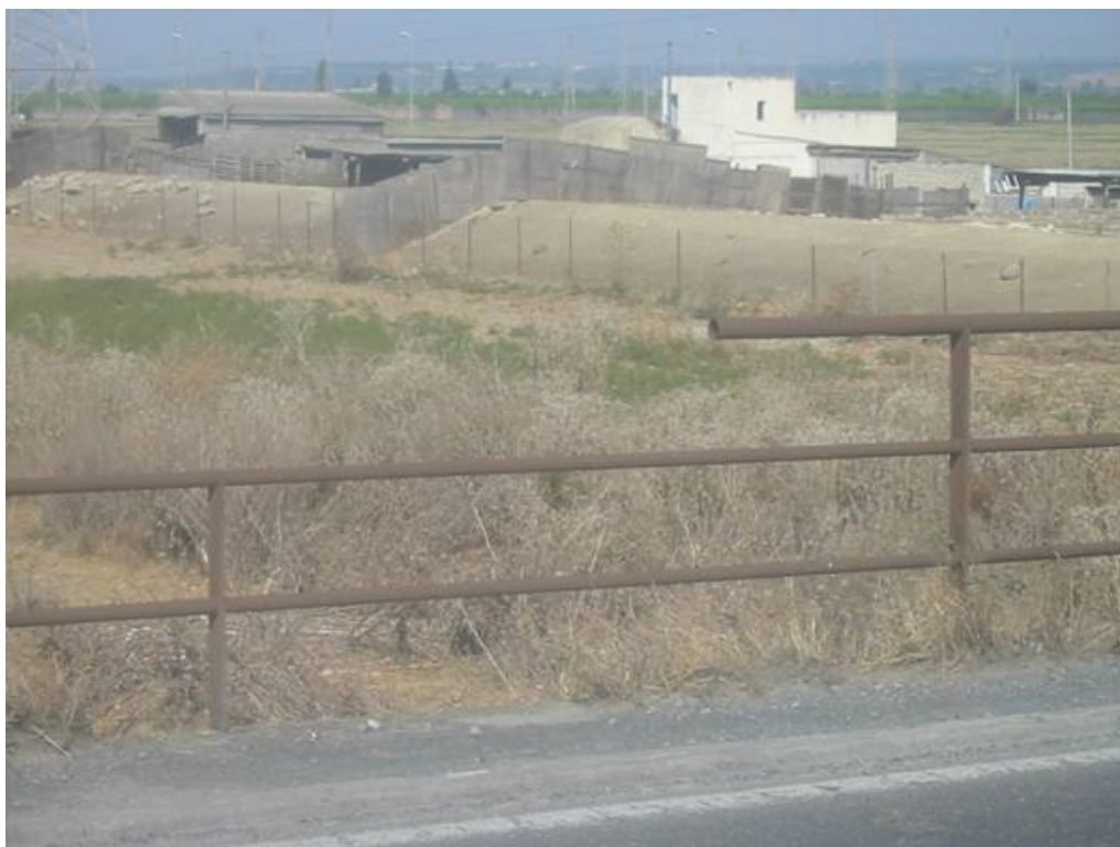
Figura 52 Barriera per bordo ponte inefficace: problema di grado elevato.
