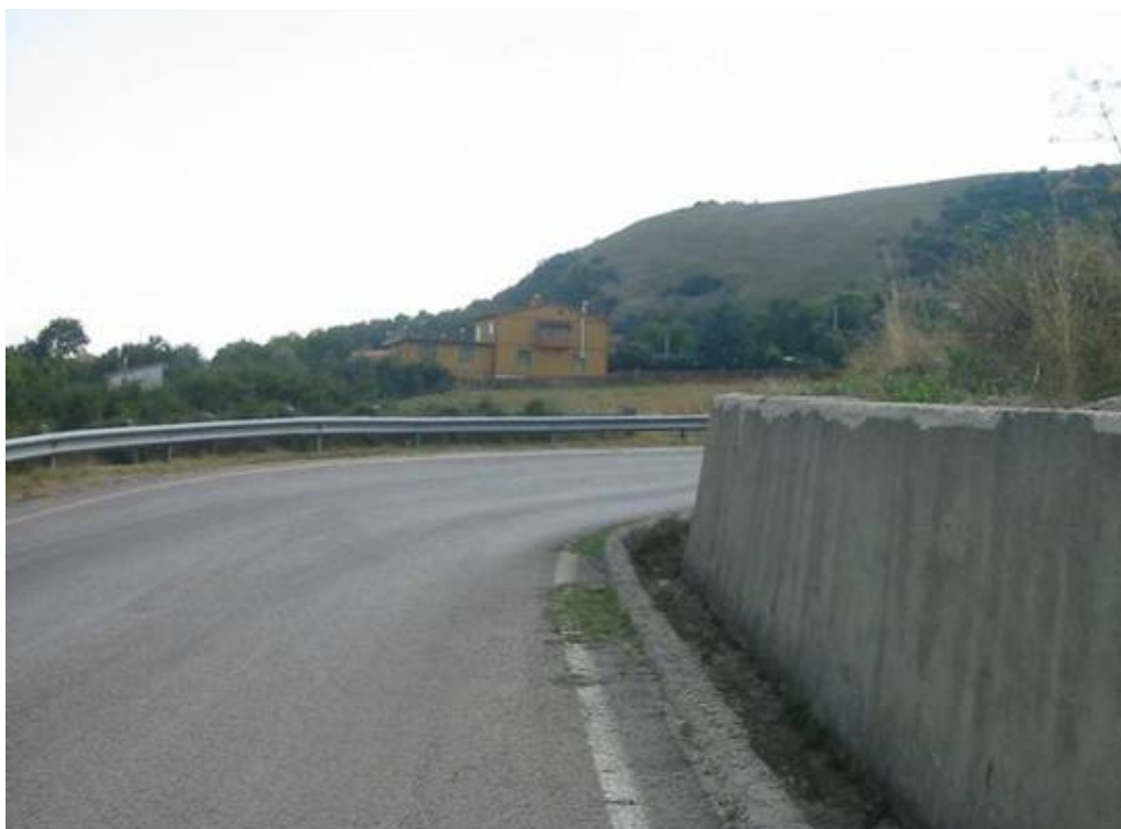
Figura 29 Mancanza di visibilità in curva: problema di grado elevato.
