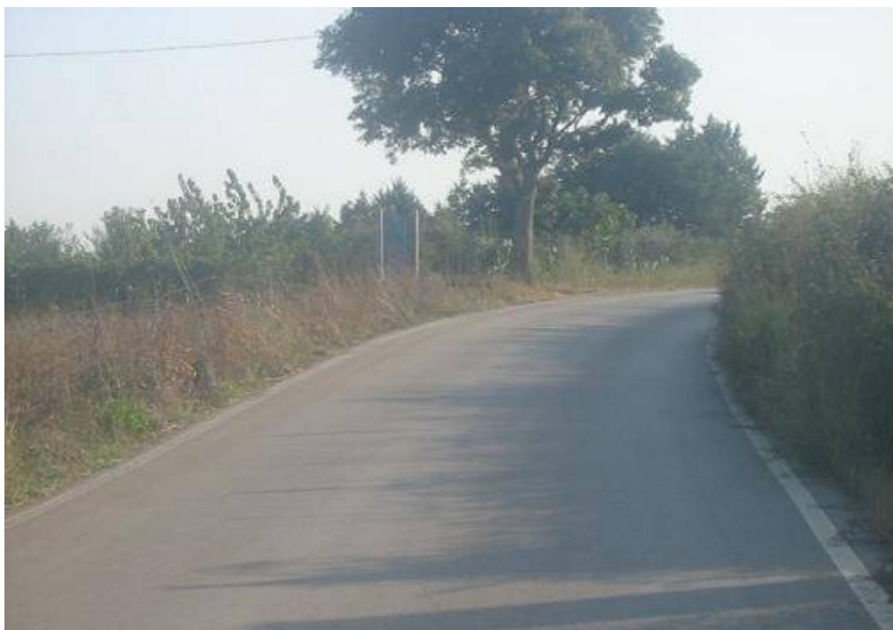
Figura 34 Strisce di margine lievemente degradate: problema di grado basso.
