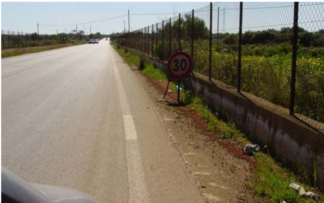
Figura A7 - Segnaletica orizzontale inefficace.
