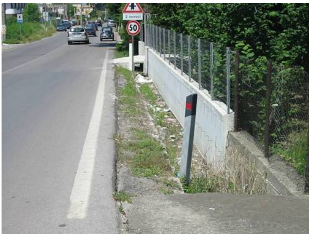
Figura 13 Delineatori installati all'interno di una cunetta rettangolare: problema di grado elevato.
