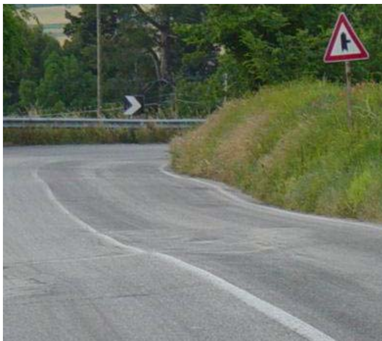
Figura 44 Irregolarità della pavimentazione in ingresso curva: problema di grado elevato.
