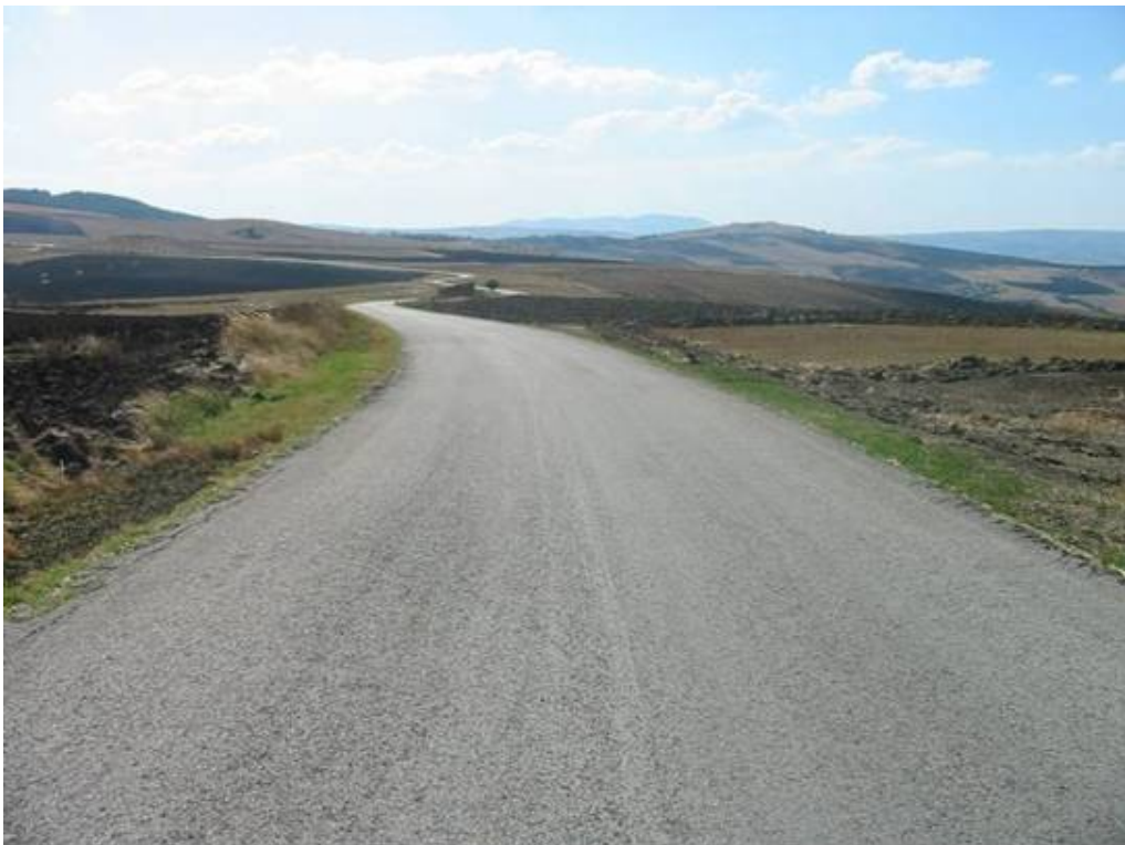
Figura 33 Strisce di margine non presenti: problema di grado elevato.
