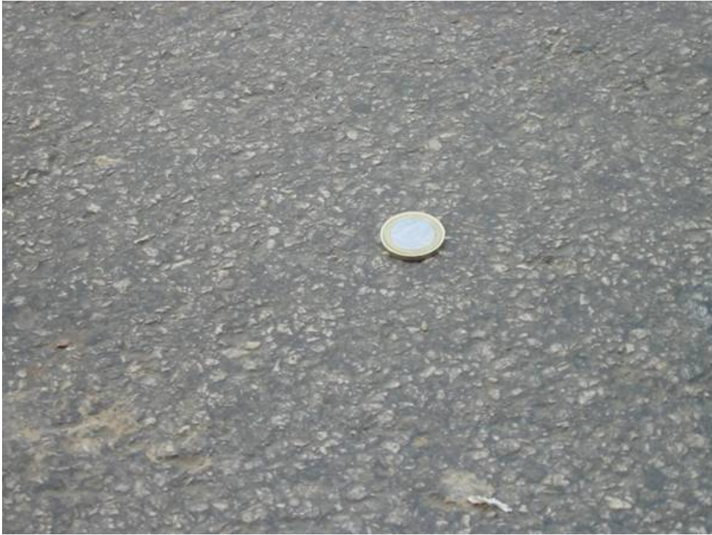
Figura 41 Assenza di macrorugosità e risalita di bitume.
