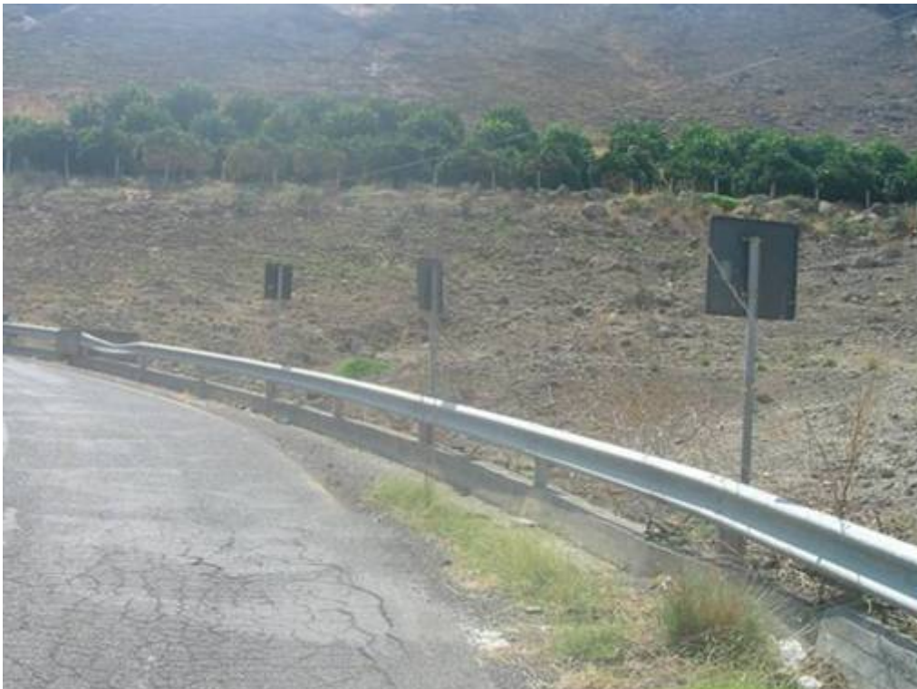
Figura 6 Assenza di delineatori in una direzione di marcia: problema di grado elevato.
