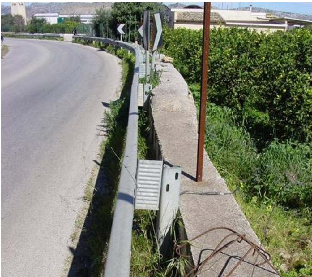
Figura A23 - Barriera inefficace a causa della presenza del muro a tergo- direzione -----.
