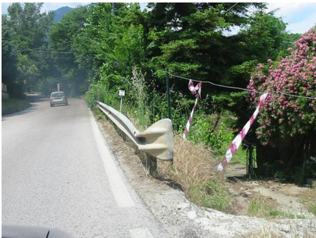
Figura 55 Terminale di barriera per bordo laterale privo di dispositivo ad assorbimento di energia: problema di grado elevato.
