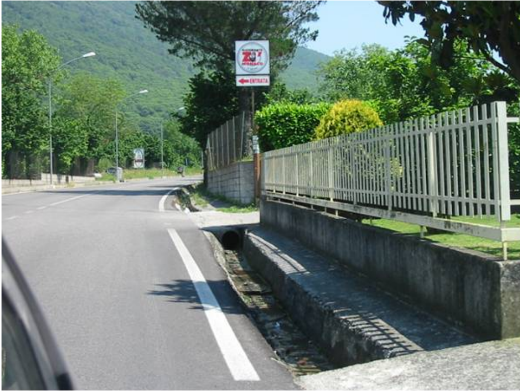
Figura 71 Cunetta trapezia non protetta: problema di grado elevato.
