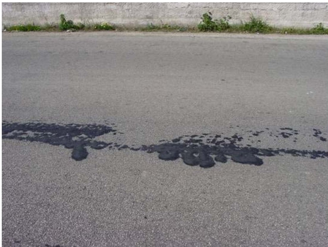
Figura A13 - Tracce di bitume sulla pavimentazione.
